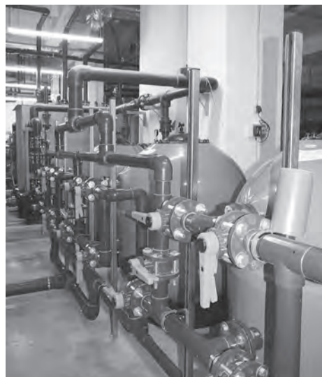
Циркулирующая в бассейне вода проходит через фильтры оборудования водоподготовки
