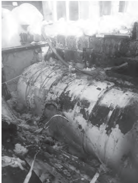
Газовый баллон после возгорания кабеля остался невредим
